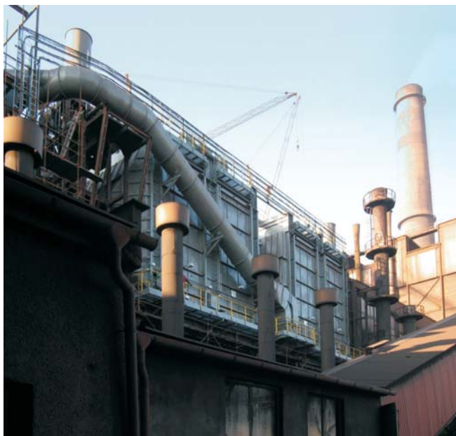
Odlučovače plynů v ArcelorMittal Ostrava
