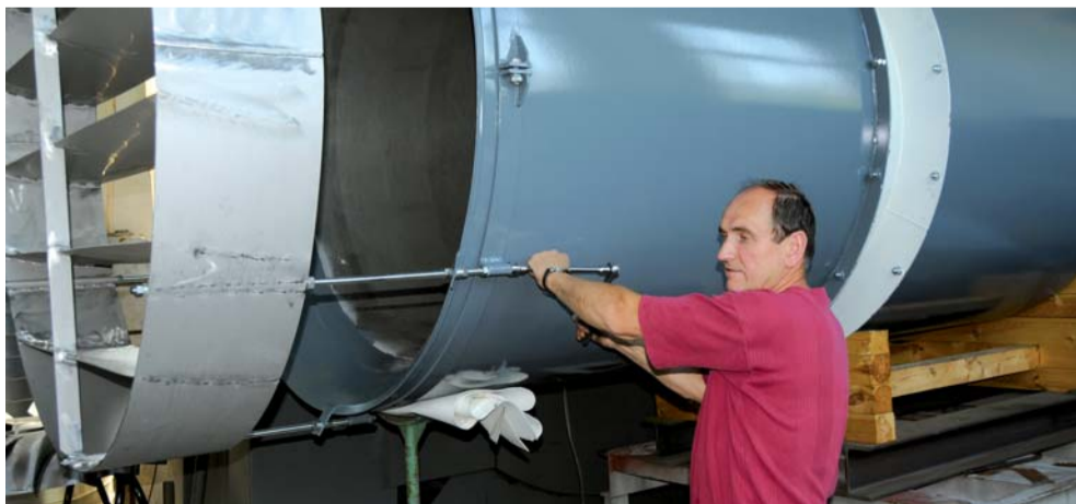
Servisní technik Jan Hejhal při montáži deflektoru na APWR 1400 pro tunel Dobrovského.
