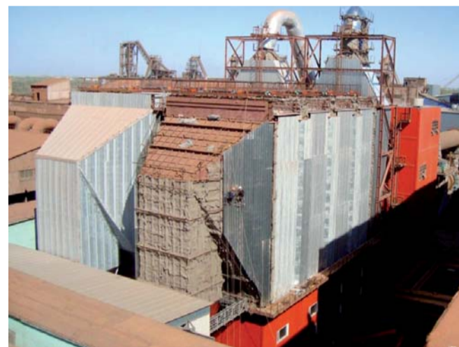
Pohled na elektrický odlučovač před uvedením do provozu v Pavlodaru
