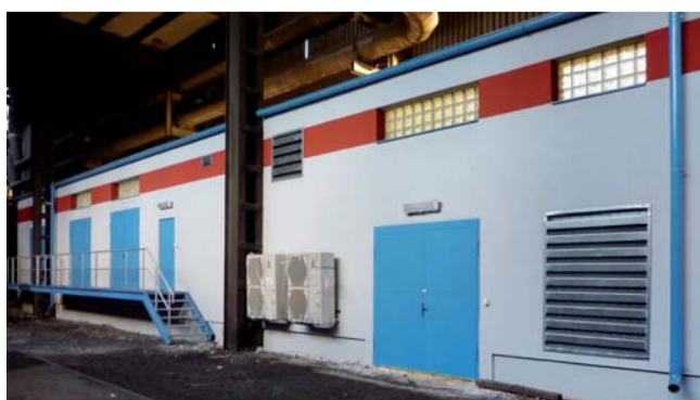
Rozvodna a stanice stlačeného vzduchu.
