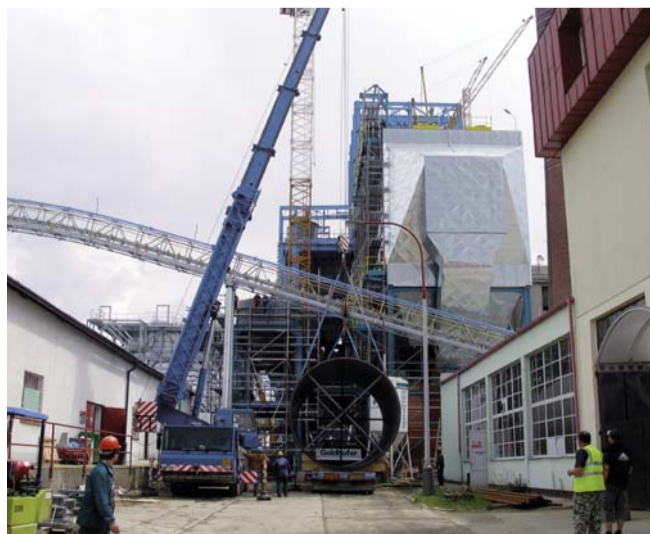
Problém způsobil malý vnitrostavební prostor.
