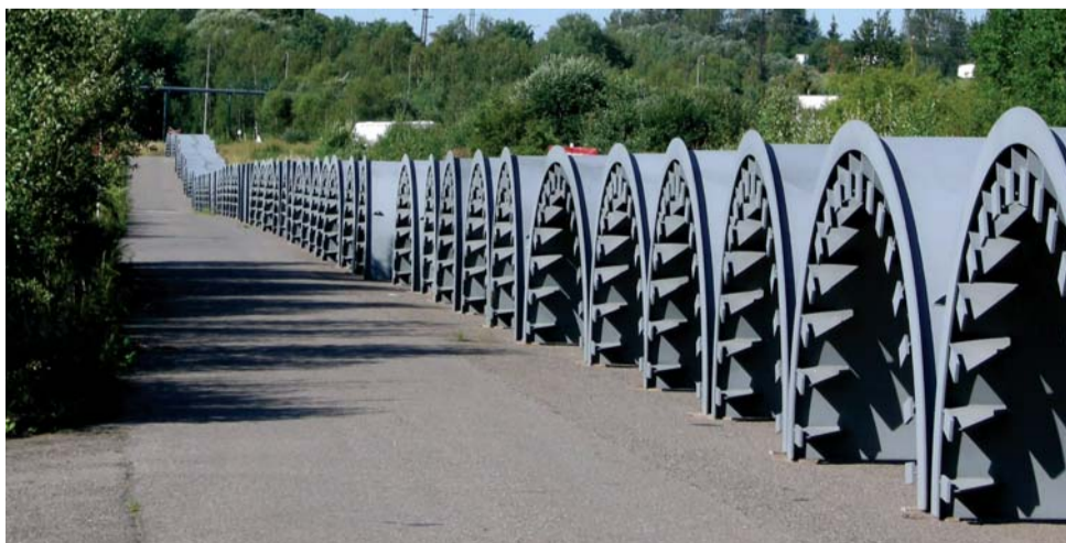
Potrubí pro elektrárnu Belchatow
